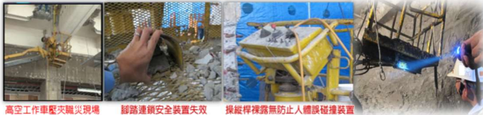
高空工作車壓夾職災現場
